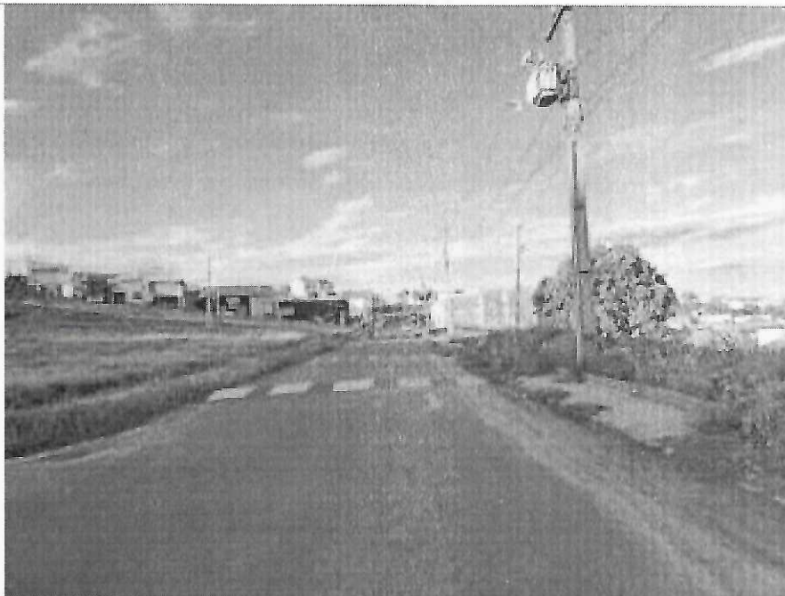
FOTO 04: Execução de revestimento, calçadas, rampas e sinalização de trânsito na Avenida Nova Aliança entre Rua Vicente Martellosso e Rua Nestor Volpato.
