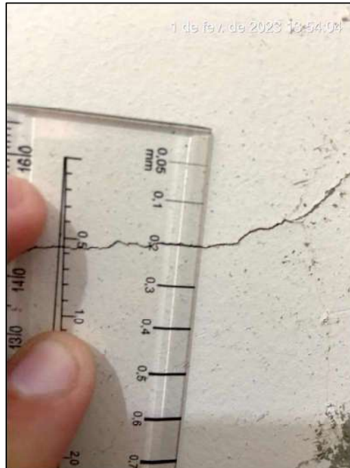
Figura 9. Em detalhe a Figura acima, destacando aferição de abertura de fissura (e: 0,20 mm). FONTE: Acervo Técnico da Vistoria.
