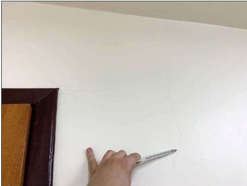
Figura 61. Outro detalhe da Figura acima. FONTE: Acervo Técnico da Vistoria.
