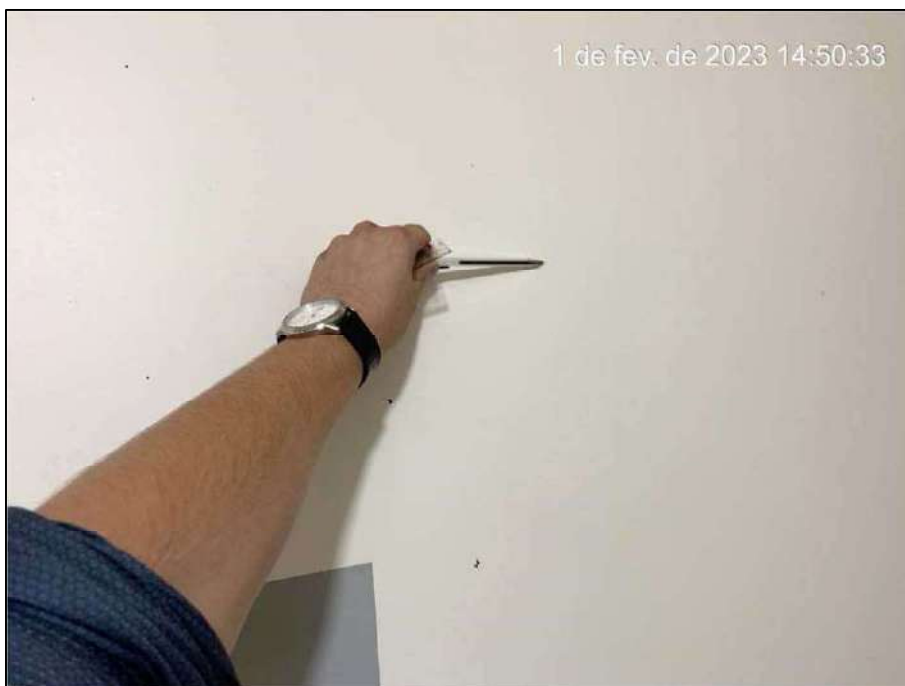
Figura 81. Em detalhe a Figura acima, destacando fissura de conformação diagonal. FONTE: Acervo Técnico da Vistoria.
