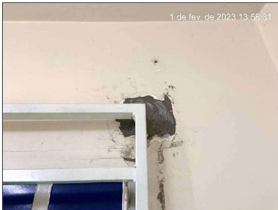
Figura 18. Em detalhe a Figura acima, destacando chumbamento da grade de proteção sem revestimento decorativo, além de fissuras. FONTE: Acervo Técnico da Vistoria.
