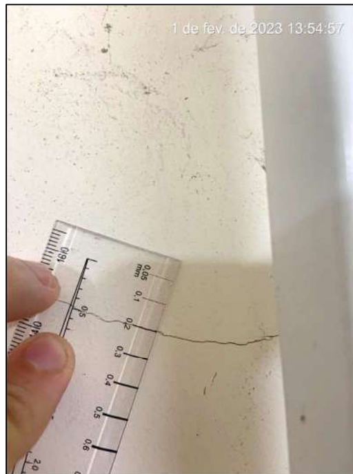
Figura 16. Em detalhe a Figura acima, destacando aferição de abertura de fissura (e: 0,20mm). FONTE: Acervo Técnico da Vistoria.
