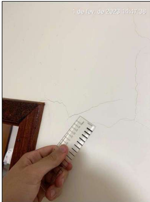
Figura 86. Outro detalhe de Figura acima, destacando fissura. FONTE: Acervo Técnico da Vistoria.
