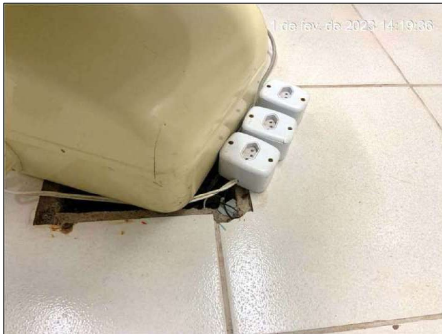
Figura 56. Em detalhe a Figura acima, destacando instalações ordinárias (EE e ED) improvisadas. FONTE: Acervo Técnico da Vistoria.
