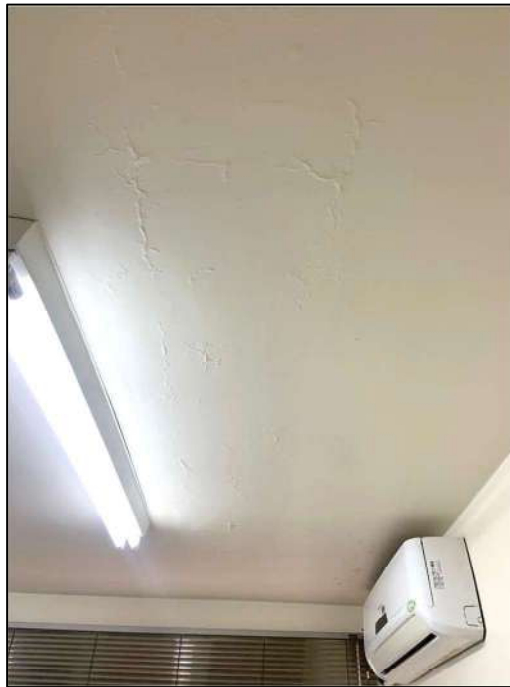
Figura 54. Vista parcial da laje de teto, destacando deterioração do revestimento decorativo em face infiltrações de umidade. FONTE: Acervo Técnico da Vistoria.
