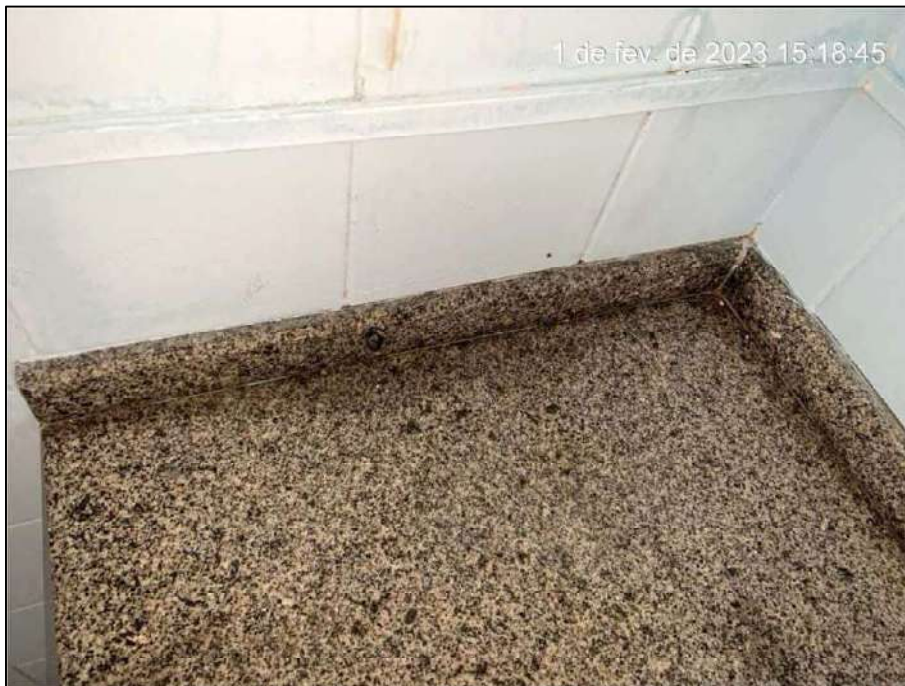
Figura 114. Outro detalhe da Figura acima, destacando acúmulo superficial de água na bancada em granito, na região em que foram constatadas manchas escorridas de umidade na parede. FONTE: Acervo Técnico da Vistoria.
