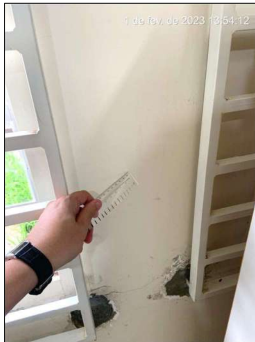
Figura 10. Outro detalhe de Figura acima, destacando fissura de conformação horizontal. FONTE: Acervo Técnico da Vistoria.
