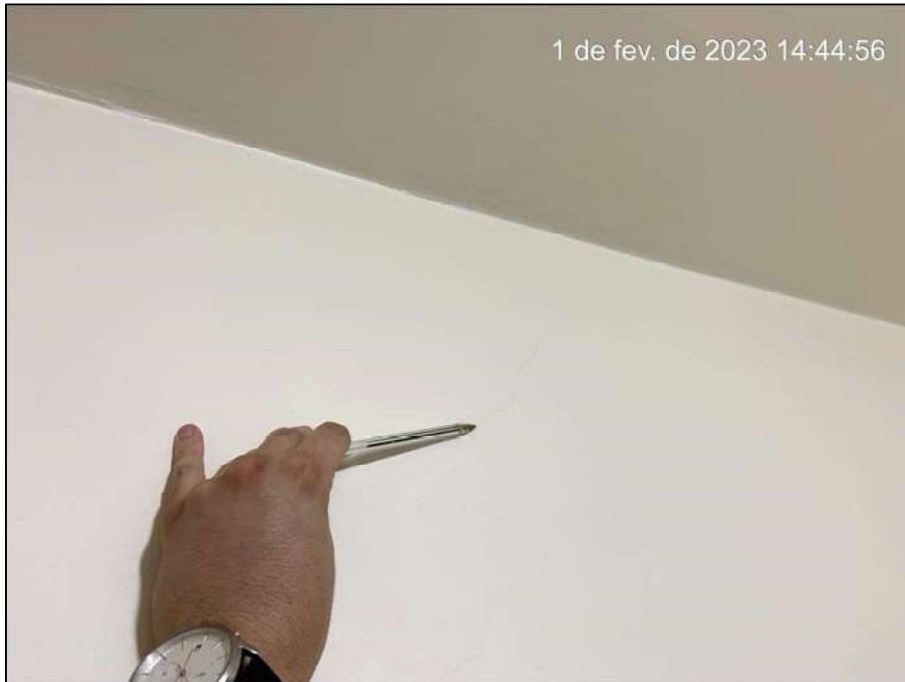
Figura 79. Continuação da fissura de conformação diagonal da Figura supra. FONTE: Acervo Técnico da Vistoria.
