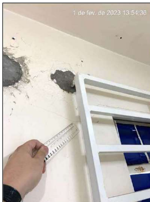
Figura 15. Em detalhe a Figura acima, destacando fissuras. FONTE: Acervo Técnico da Vistoria.
