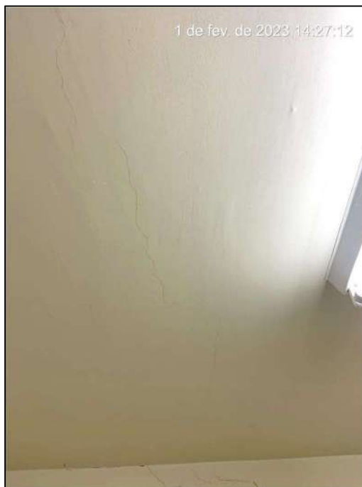
Figura 52. Vista parcial da laje de teto, destacando fissura nessa. FONTE: Acervo Técnico da Vistoria.
