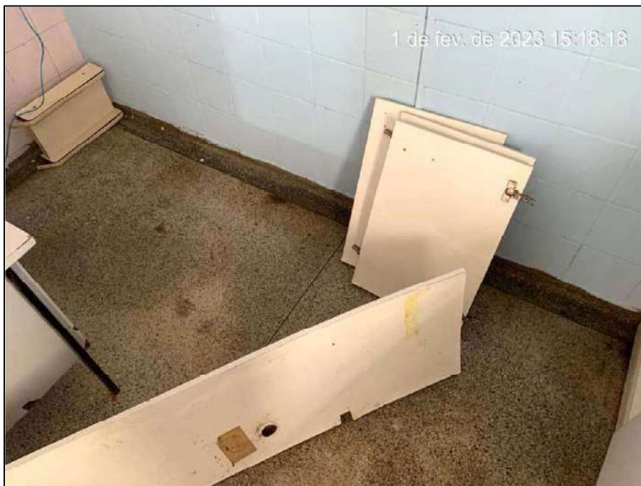
Figura 115. Vista parcial do piso da sala antiga de vacina, destacando acúmulo superficial de água e manchas de umidade. FONTE: Acervo Técnico da Vistoria.
