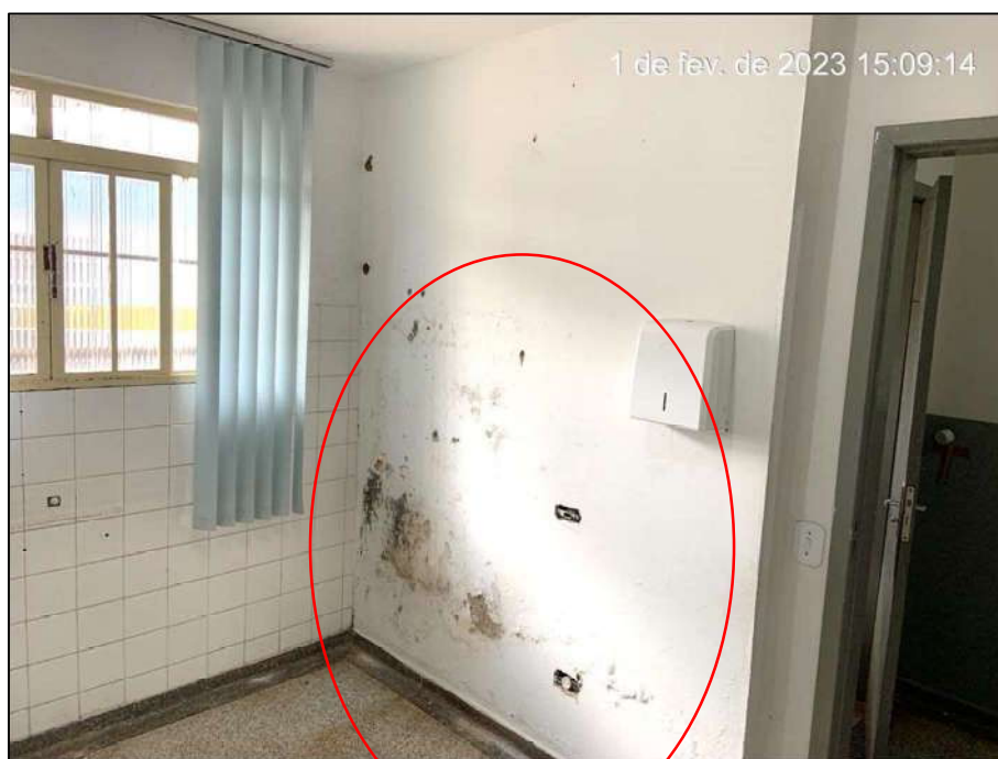
Figura 95. Vista parcial do consultório de psicologia, destacando deterioração do revestimento decorativo, além de umidade excessiva. FONTE: Acervo Técnico da Vistoria.
