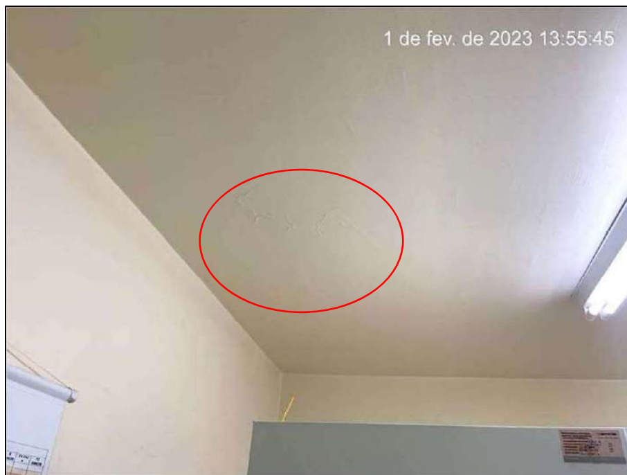
Figura 21. Em detalhe a Figura acima, destacando sinais de infiltrações de umidade na laje de teto. FONTE: Acervo Técnico da Vistoria.
