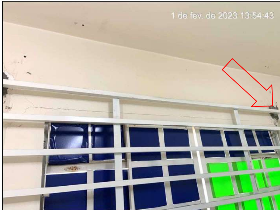
Figura 17. Outro detalhe da Figura acima, destacando fissura de conformação horizontal. FONTE: Acervo Técnico da Vistoria.
