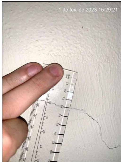
Figura 102. Em detalhe a Figura acima, destacando aferição de abertura de fissura (e: 0,40 mm). FONTE: Acervo Técnico da Vistoria.
