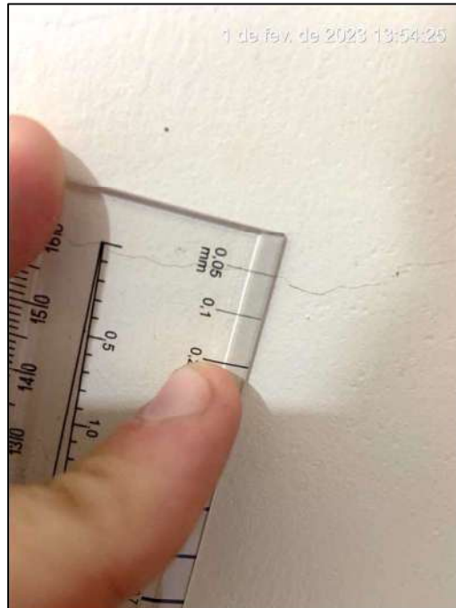
Figura 11. Em detalhe a Figura acima, destacando aferição de abertura de fissura (e: 0,05 mm). FONTE: Acervo Técnico da Vistoria.
