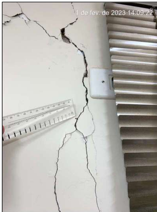
Figura 32. Em detalhe a Figura acima, destacando fissura de conformação vertical. FONTE: Acervo Técnico da Vistoria.
