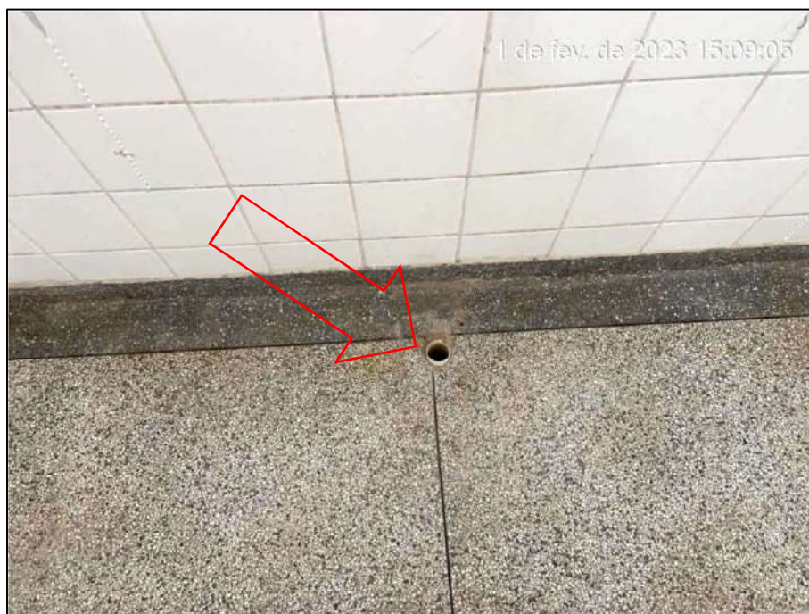
Figura 94. Em detalhe a Figura acima, destacando tubulação da instalação hidrossanitária sem vedação. FONTE: Acervo Técnico da Vistoria.
