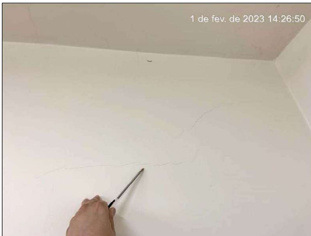
Figura 49. Em detalhe a Figura acima, destacando fissuras. FONTE: Acervo Técnico da Vistoria.
