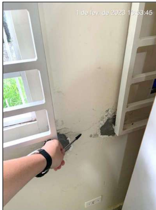
Figura 8. Em detalhe a Figura acima, destacando fissura de conformação horizontal. FONTE: Acervo Técnico da Vistoria.
