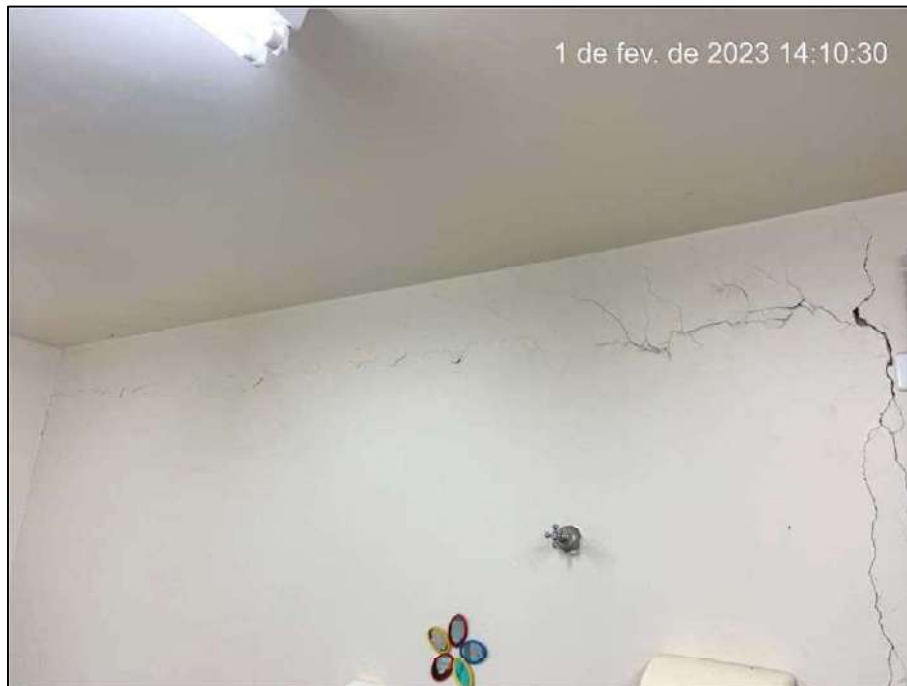
Figura 34. Outro detalhe de Figura acima, destacando fissura de conformação predominantemente horizontal do tipo escamada. FONTE: Acervo Técnico da Vistoria.
