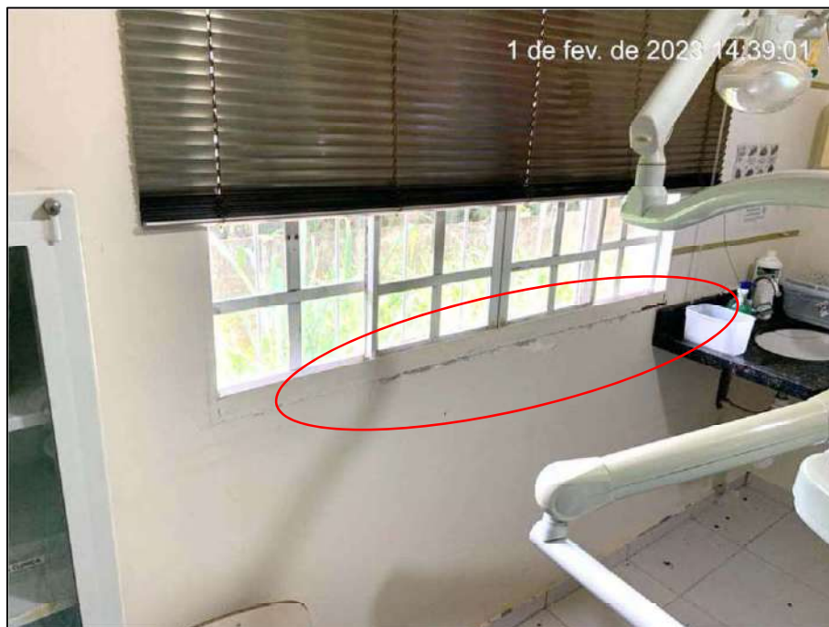
Figura 70. Outro detalhe de Figura acima, destacando deterioração na parte inferior da janela. FONTE: Acervo Técnico da Vistoria.
