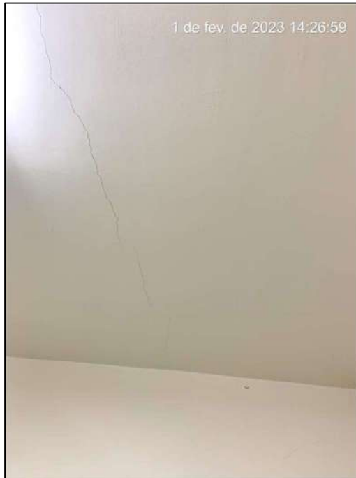
Figura 50. Outro detalhe de Figura acima, destacando fissura na laje de teto. FONTE: Acervo Técnico da Vistoria.
