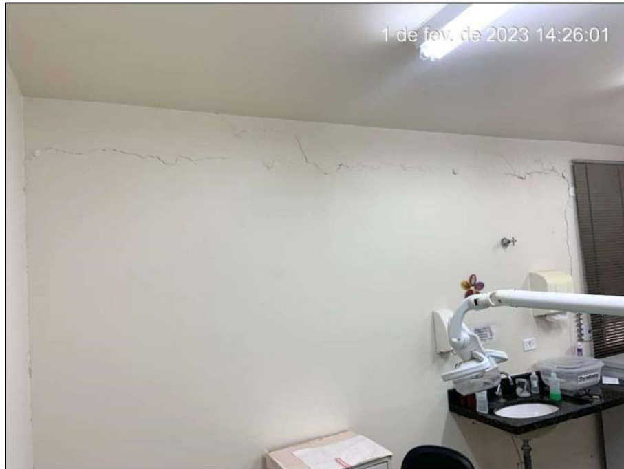
Figura 35. Detalhe da Figura acima, observando a fissura horizontal por outro ângulo. FONTE: Acervo Técnico da Vistoria.
