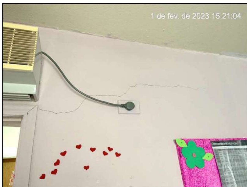
Figura 117. Em detalhe a Figura acima, destacando fissura de conformação horizontal. FONTE: Acervo Técnico da Vistoria.
