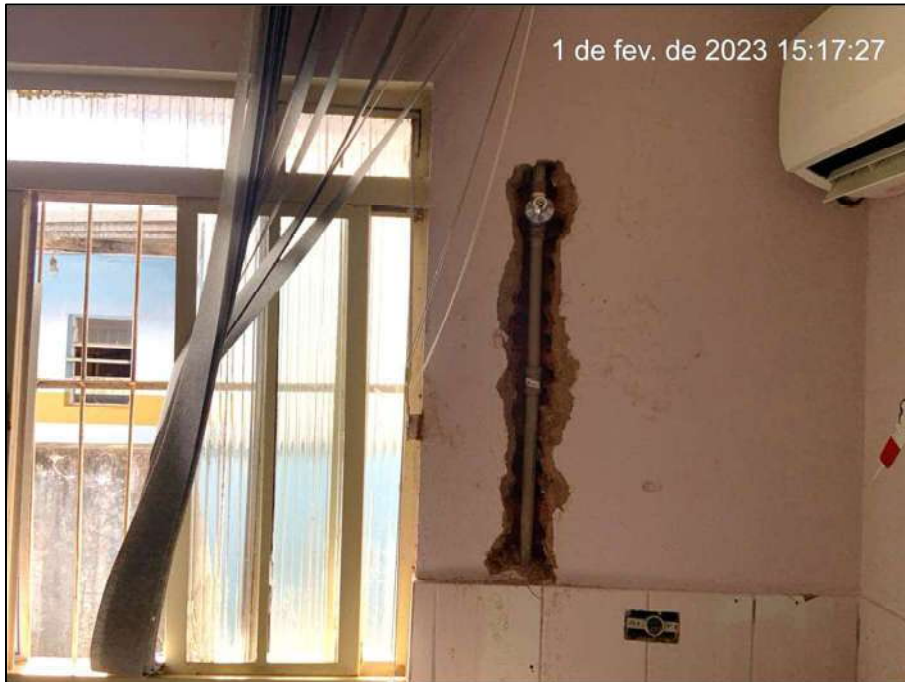
Figura 109. Em detalhe a Figura acima, destacando reparo inacabado em razão da ausência de revestimento argamassado e decorativo. FONTE: Acervo Técnico da Vistoria.
