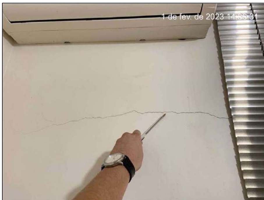
Figura 68. Em detalhe a Figura acima, destacando fissura de conformação horizontal. FONTE: Acervo Técnico da Vistoria.
