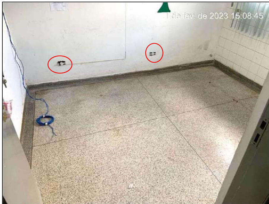
Figura 92. Vista parcial do consultório de psicologia, destacando ausência de espelhos de tomadas. FONTE: Acervo Técnico da Vistoria.
