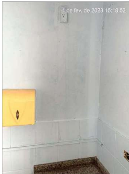
Figura 112. Em detalhe a Figura acima, destacando manchas de umidade no revestimento decorativo 1 . FONTE: Acervo Técnico da Vistoria.
