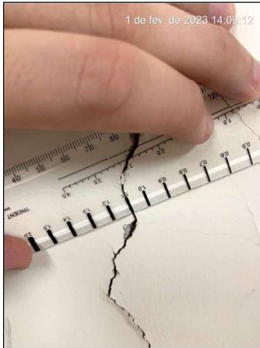
Figura 31. Em detalhe a Figura acima, destacando aferição de abertura de fissura (e: 1,10mm). FONTE: Acervo Técnico da Vistoria.
