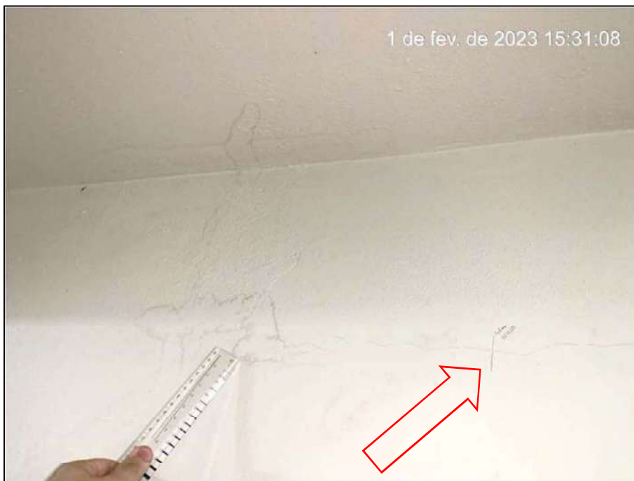
Figura 104. Em detalhe a Figura acima, destacando fissuras e sinais de umidade. FONTE: Acervo Técnico da Vistoria.
