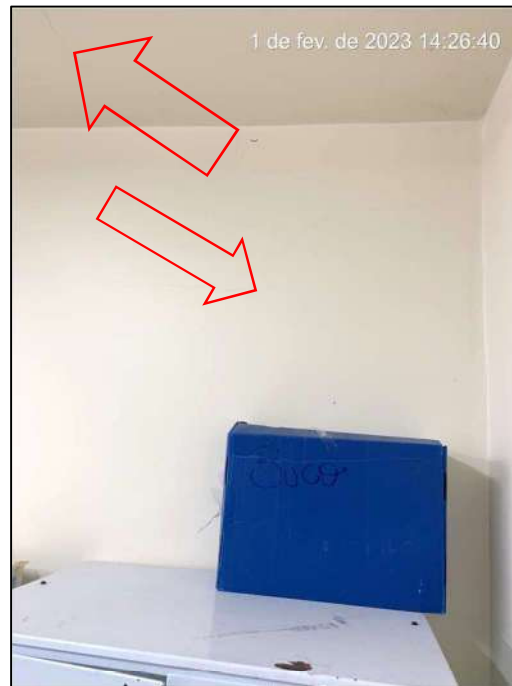
Figura 48. Em detalhe a Figura acima, destacando fissuras. FONTE: Acervo Técnico da Vistoria.
