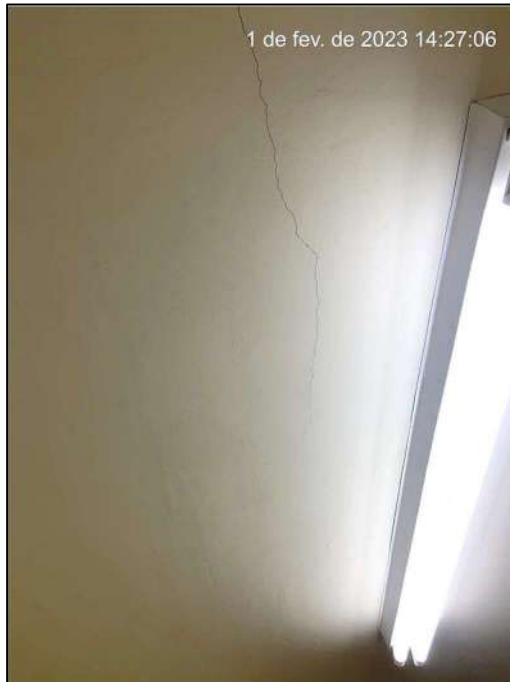
Figura 51. Vista parcial da laje, destacando fissura na laje de teto (continuação da fissura apontada na Figura acima). FONTE: Acervo Técnico da Vistoria.
