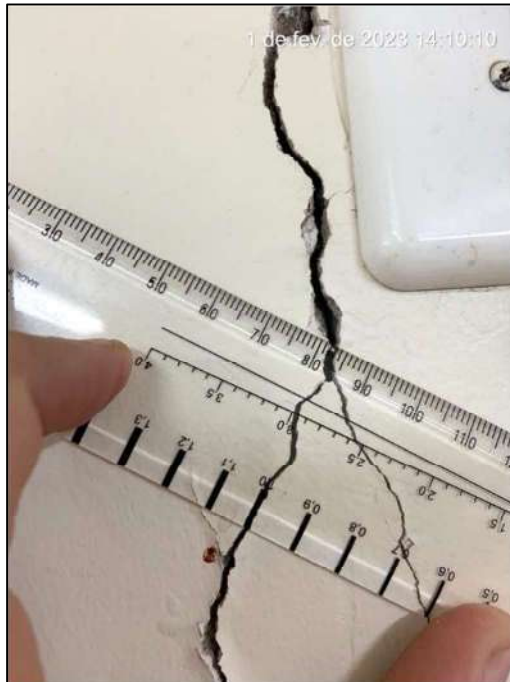
Figura 33. Em destaque a Figura acima, destacando aferição de abertura de fissura (e: 1,0 mm). FONTE: Acervo Técnico da Vistoria.
