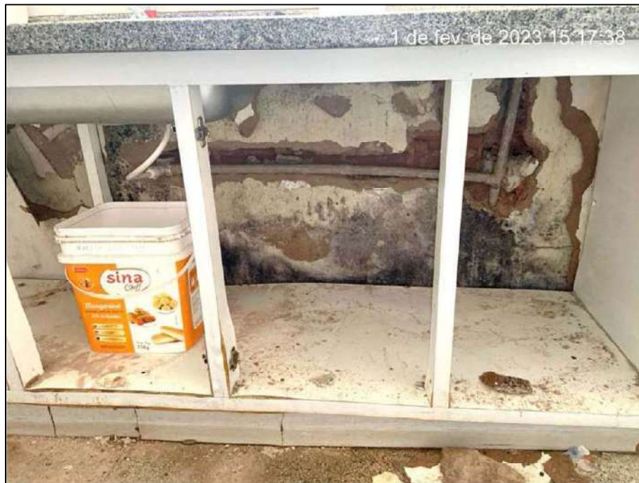
Figura 110. Outro detalhe de Figura acima, destacando reparos inacabados, bem como deterioração do revestimento decorativo e argamassado em razão de umidade excessiva. FONTE: Acervo Técnico da Vistoria.
