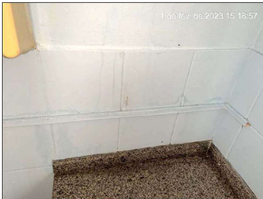
Figura 113. Em detalhe a Figura supra, destacando manchas escorridas. FONTE: Acervo Técnico da Vistoria.
