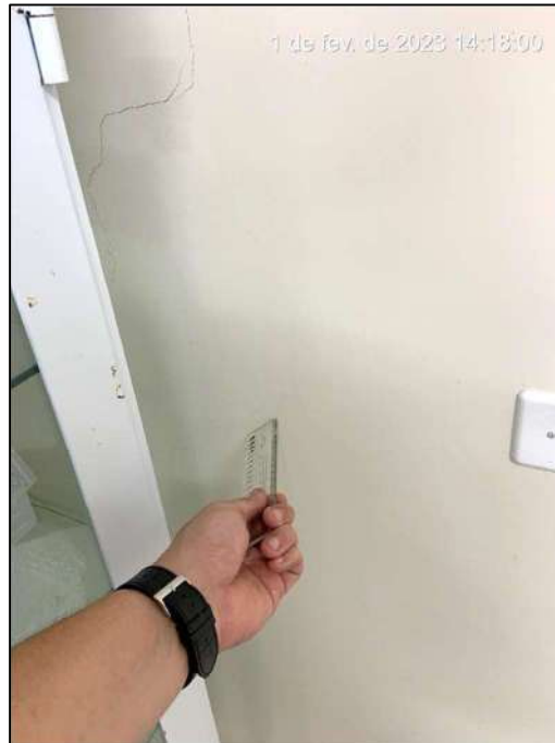
Figura 45. Outro detalhe de Figura acima, destacando fissura de conformação diagonal. FONTE: Acervo Técnico da Vistoria.
