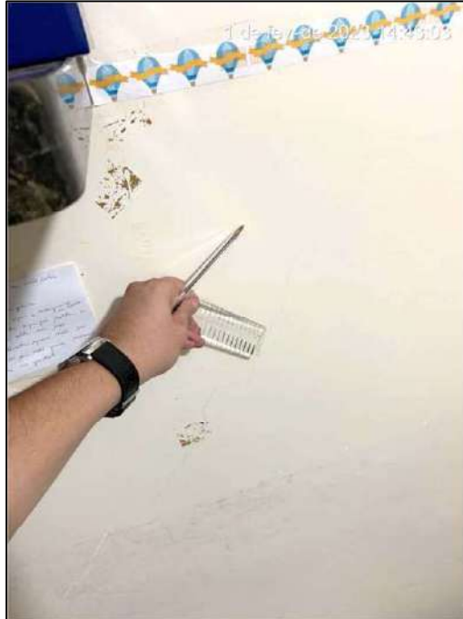
Figura 76. Outro detalhe de Figura acima, destacando fissura de conformação diagonal. FONTE: Acervo Técnico da Vistoria.
