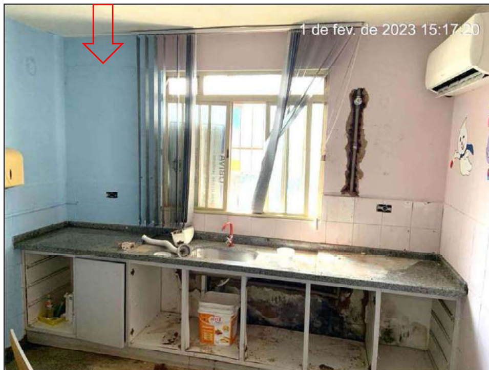
Figura 107. Vista parcial da sala antiga de vacina, destacando sinais de reparos inacabados, além de deterioração do revestimento decorativo (efeitos de umidade excessiva), além da ausência de espelhos nas tomadas. FONTE: Acervo Técnico da Vistoria.
