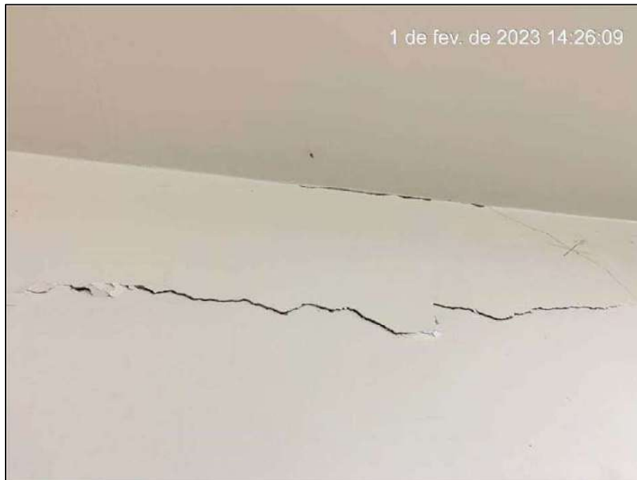
Figura 36. Em detalhe a Figura acima, destacando fissuras escamadas e destacamento parcial do revestimento decorativo e argamassado. FONTE: Acervo Técnico da Vistoria.
