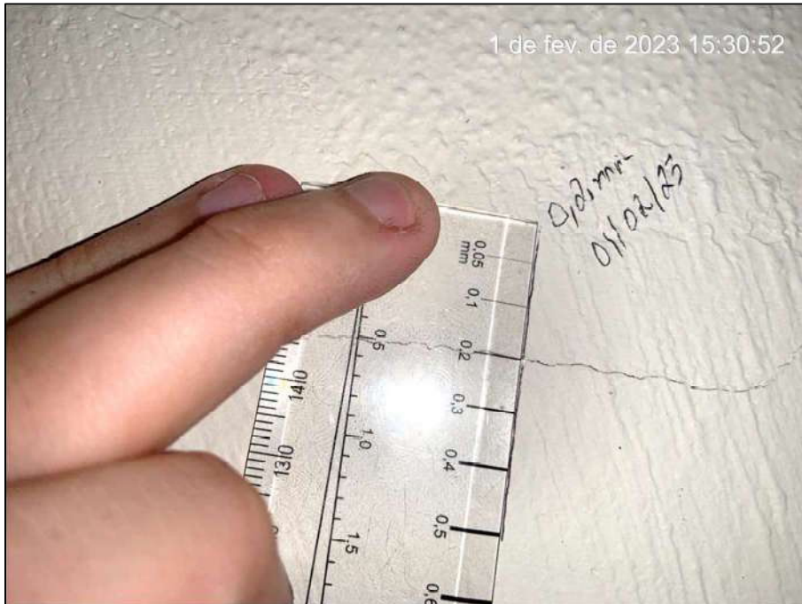
Figura 105. Em detalhe a Figura acima, destacando aferição de abertura de fissura (e: 0,20 mm). FONTE: Acervo Técnico da Vistoria.
