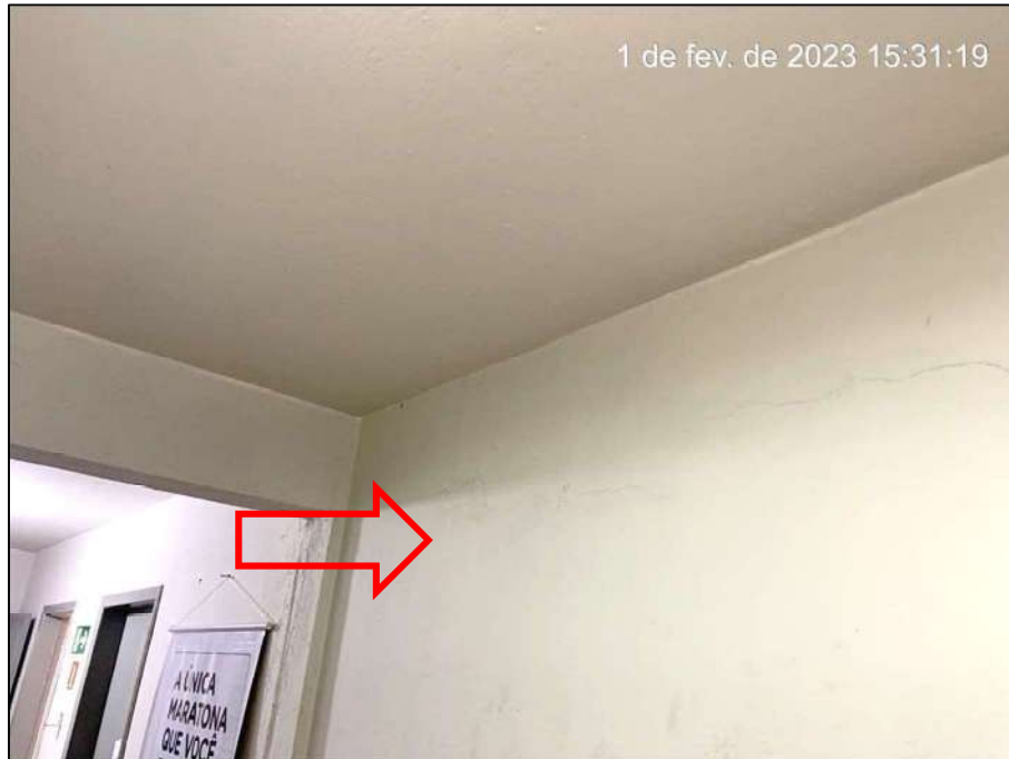
Figura 103. Vista parcial da parede interna de divisa entre corredor e sala antiga de vacina. FONTE: Acervo Técnico da Vistoria.
