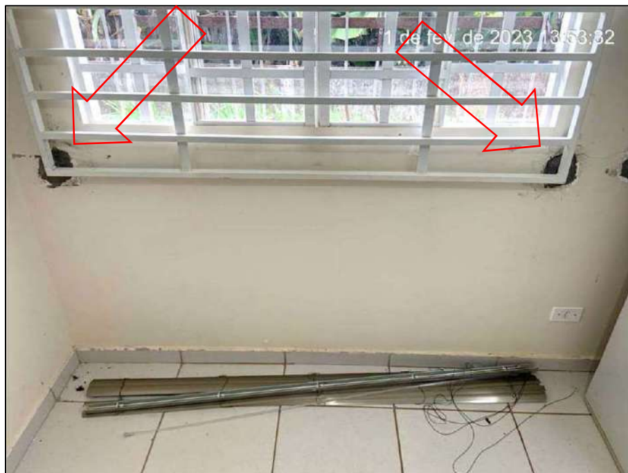
Figura 13. Vista parcial da sala de vacina - atual, observando parede do fundo do EAS, destacando ponto de chumbamento sem o revestimento decorativo (película de pintura). FONTE: Acervo Técnico da Vistoria.
