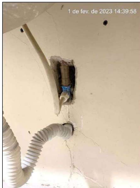
Figura 72. Outro detalhe de Figura acima, destacando fissuras e ausência de revestimento argamassado. FONTE: Acervo Técnico da Vistoria.
