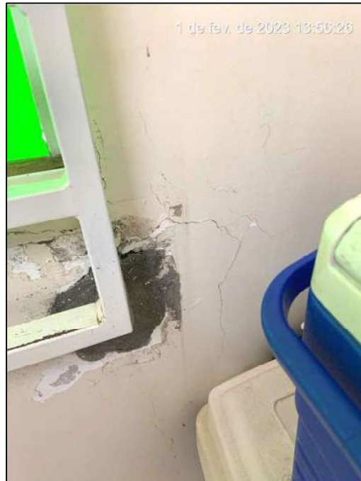
Figura 19. Vista do vértice inferior de janela da sala de vacina atual, destacando chumbamento de grade de proteção sem revestimento decorativo e com fissuras. FONTE: Acervo Técnico da Vistoria.
