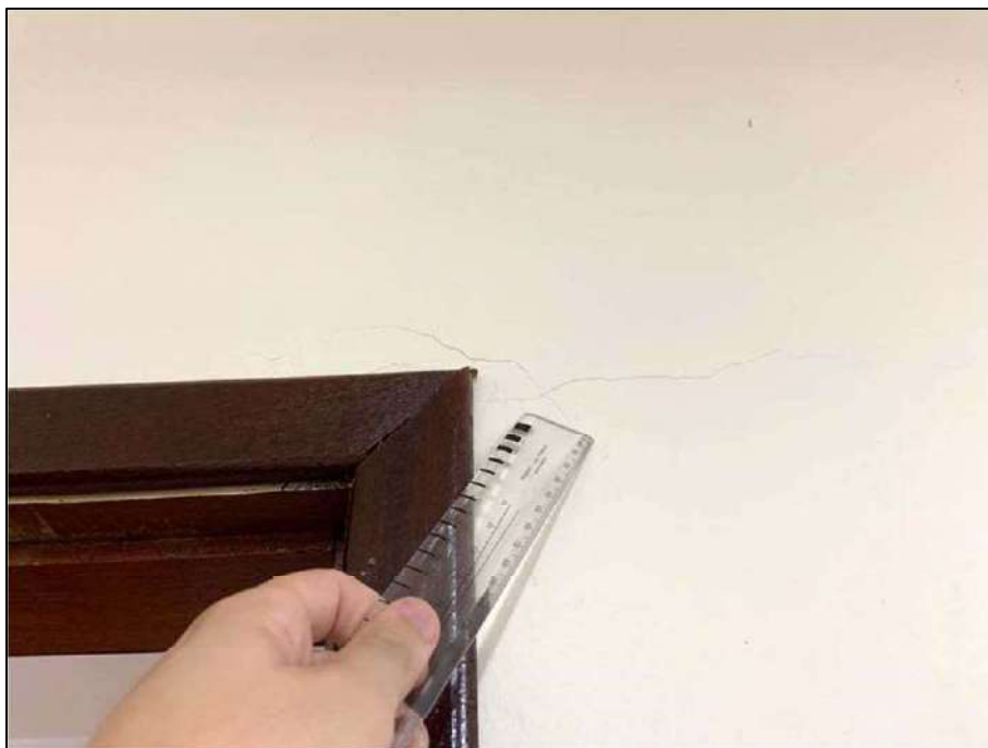
Figura 59. Em detalhe a Figura acima, destacando fissuras no vértice superior da porta de acesso. FONTE: Acervo Técnico da Vistoria.
