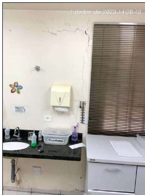
Figura 29. Em detalhe da Figura acima, destacando fissura de conformação vertical. FONTE: Acervo Técnico da Vistoria.
