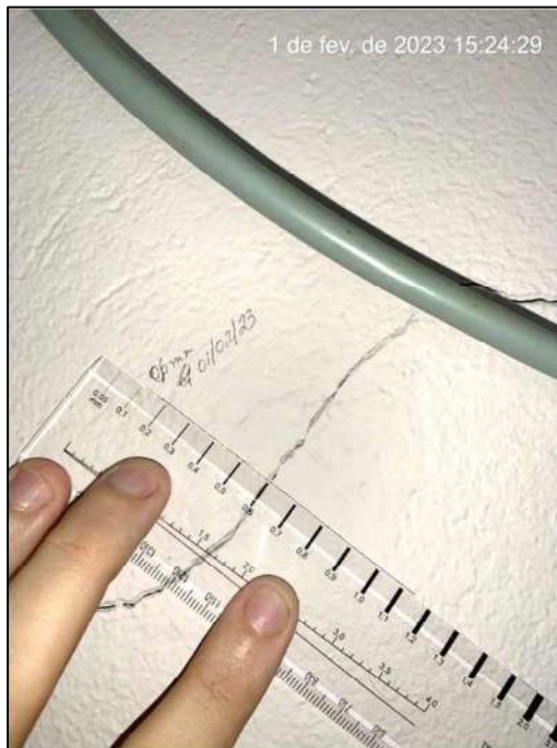
Figura 118. Em detalhe a Figura acima, destacando aferição de abertura de fissura (e: 0,60mm). FONTE: Acervo Técnico da Vistoria.
