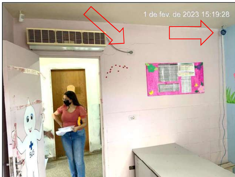
Figura 116. Vista parcial da sala antiga de vacina, destacando furo 2 na laje para passagem de fiação. FONTE: Acervo Técnico da Vistoria.
