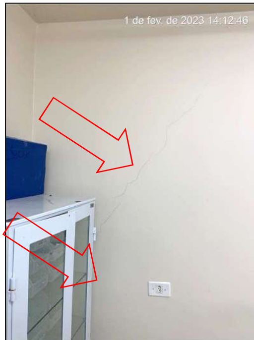
Figura 42. Em detalhe a Figura supra, destacando fissuras de conformação diagonal. FONTE: Acervo Técnico da Vistoria.
