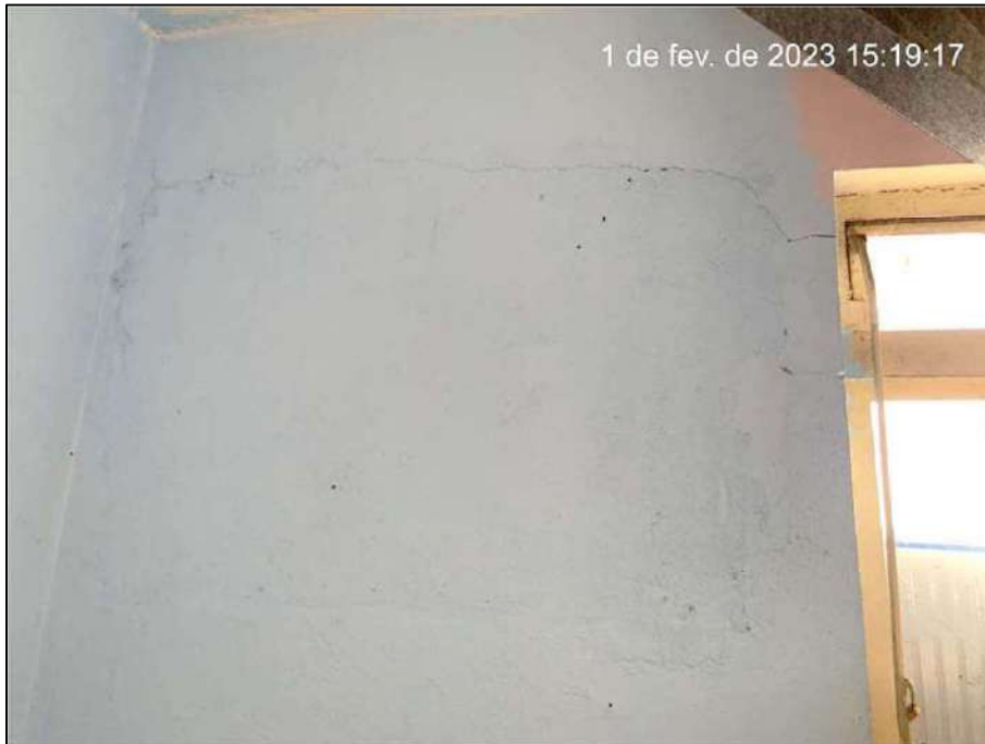
Figura 108. Em detalhe a Figura acima, destacando fissura no entorno de fechamento em alvenaria. FONTE: Acervo Técnico da Vistoria.
