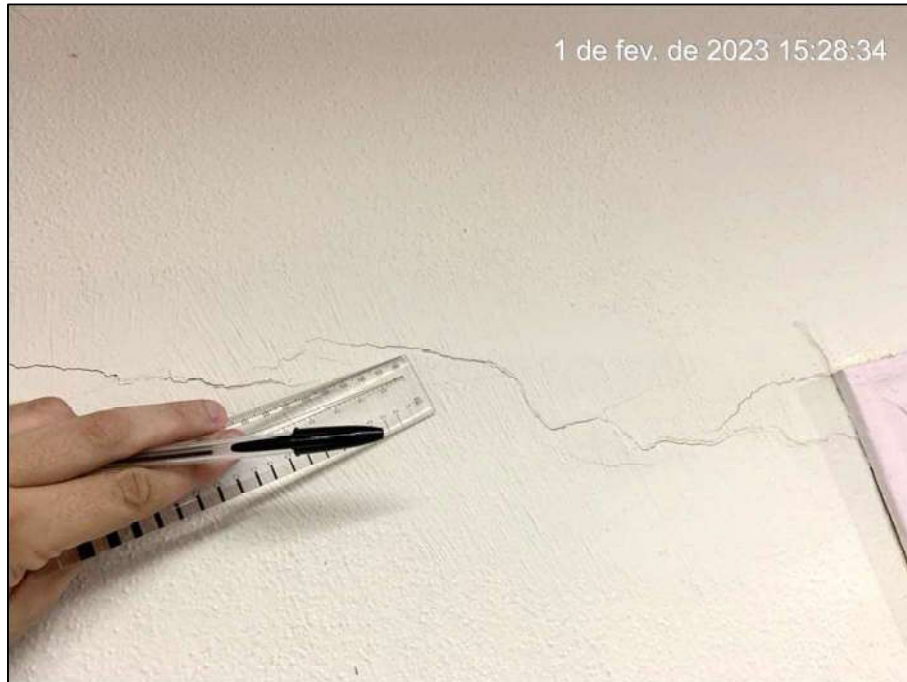
Figura 101. Em detalhe a Figura acima, destacando fissura e sinais pretéritos de reparos. FONTE: Acervo Técnico da Vistoria.
