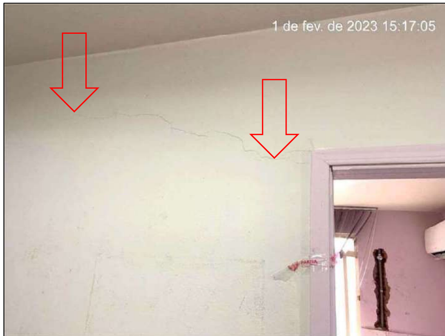
Figura 100. Outro detalhe de Figura acima, destacando fissura de conformação horizontal. FONTE: Acervo Técnico da Vistoria.
