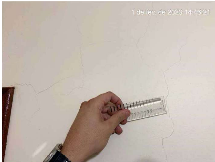
Figura 84. Em detalhe a Figura acima, destacando fissuras. FONTE: Acervo Técnico da Vistoria.
